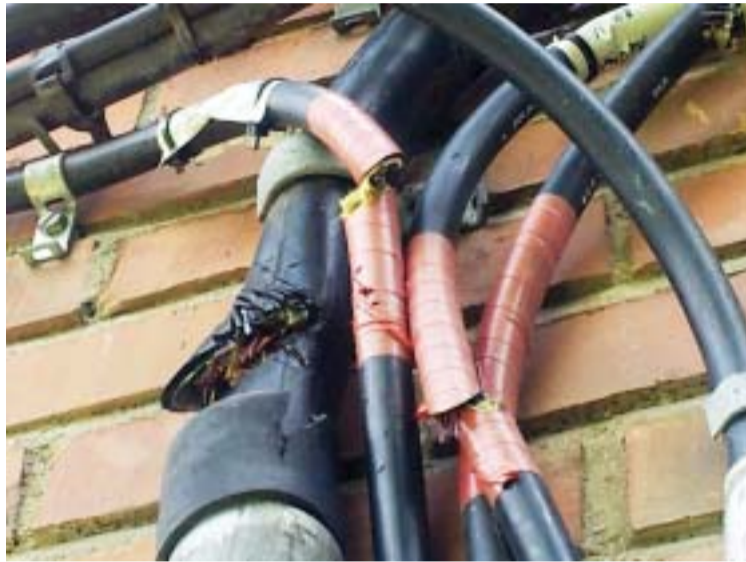
Cables cortados en la Calle Hacienda de Pavones
